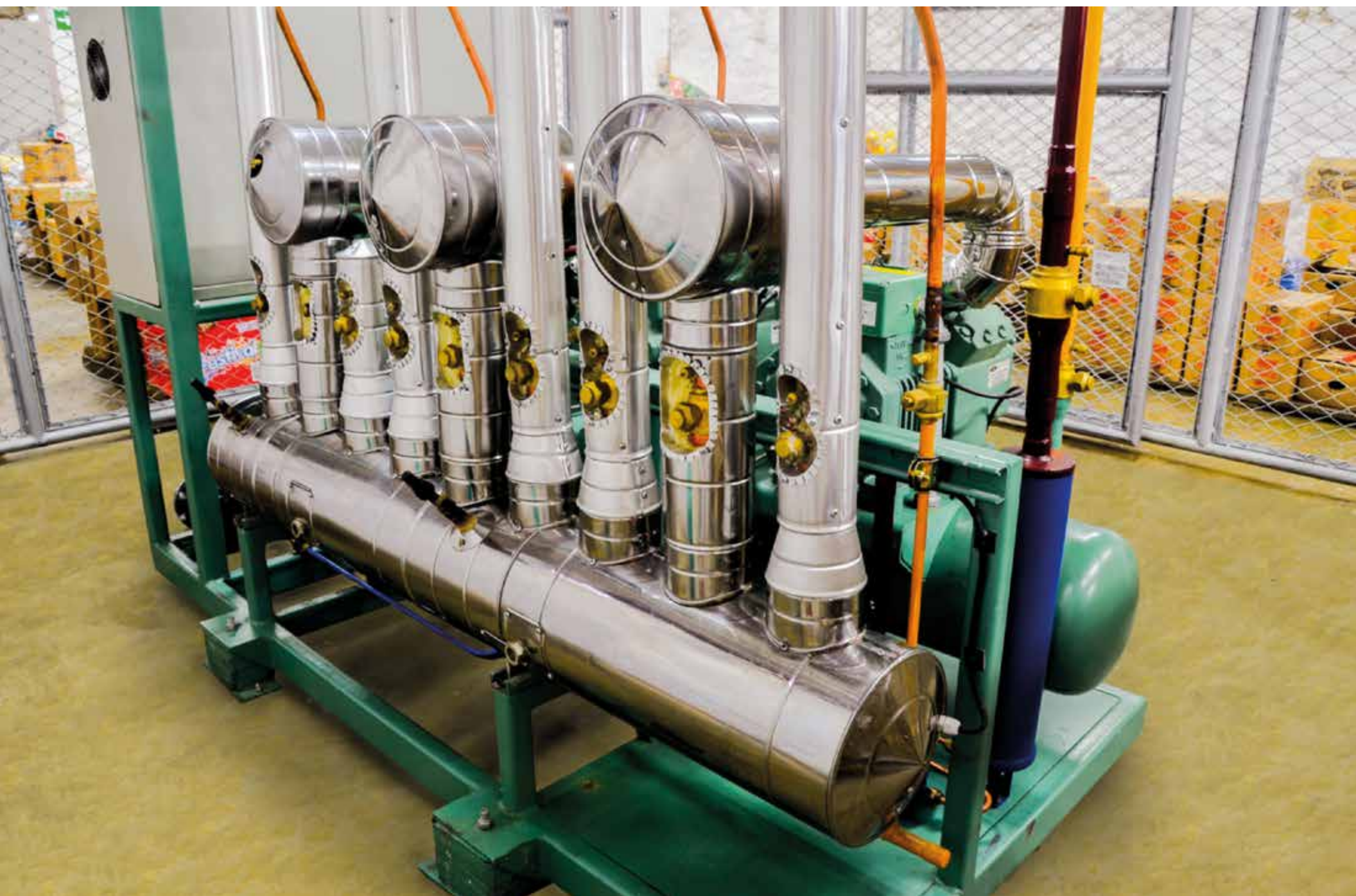
Sistema Paralelo Rack - Supermercado Comfamiliares - Manizales.
