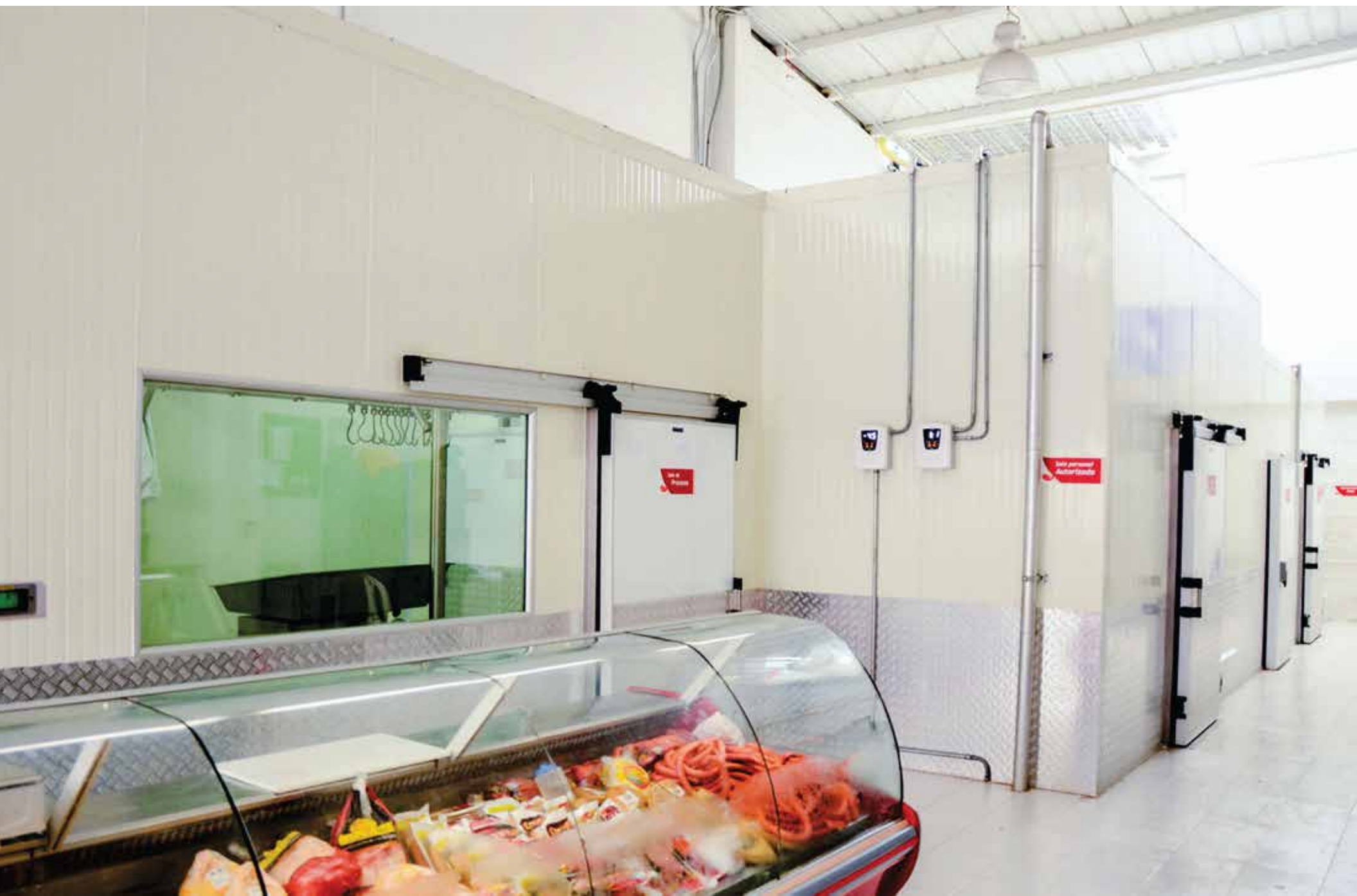
Cuartos Frios - Carnes frias Rieti - Tulua.
